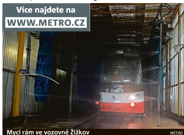
Mycí rám ve vozovně Žižkov
