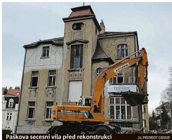
Paškova secesní vila před rekonstrukcí
