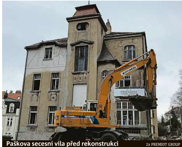
Paškova secesní vila před rekonstrukcí
