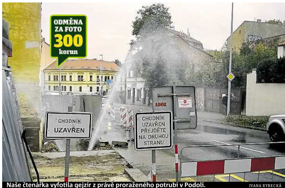
Naše čtenářka vyfotila gejzír z právě proraženého potrubí v Podolí.
