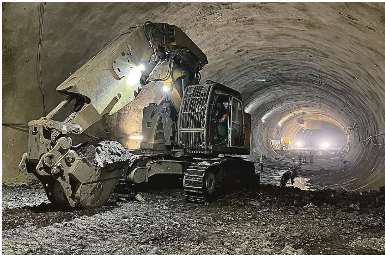
Zhruba v těchto místech vzniknou obrátové koleje pro metro. Ve tmě v dálce bude zase stanice Pankrác.
