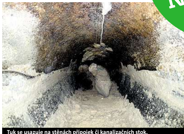
Tuk se usazuje na stěnách přípojek či kanalizačních stok.
