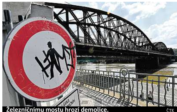
Železničnímu mostu hrozí demolice. ČTK
