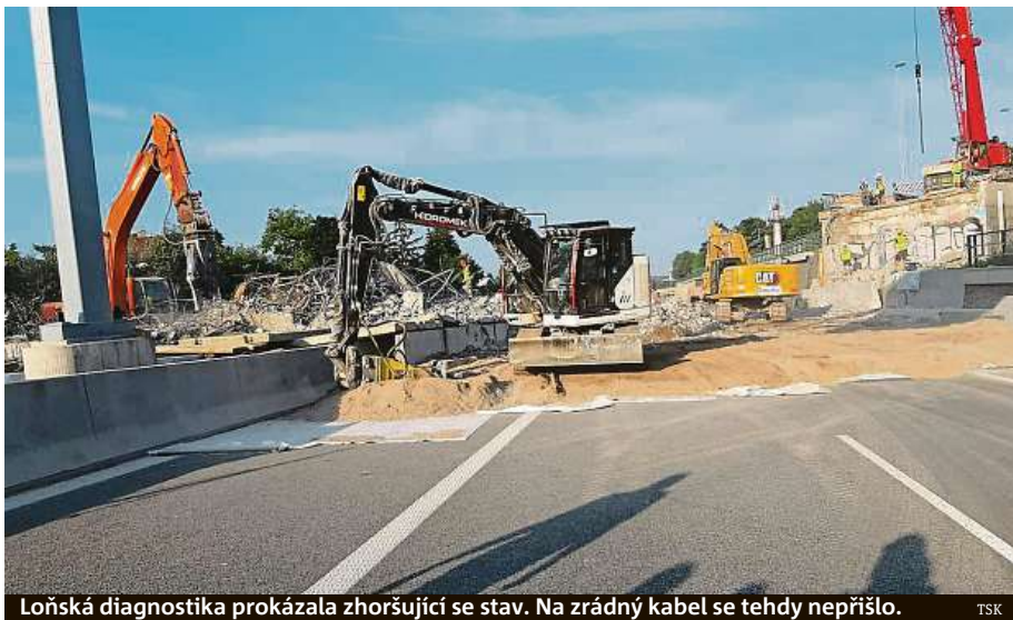
Loňská diagnostika prokázala zhoršující se stav. Na zrádný kabel se tehdy nepřišlo. TSK
