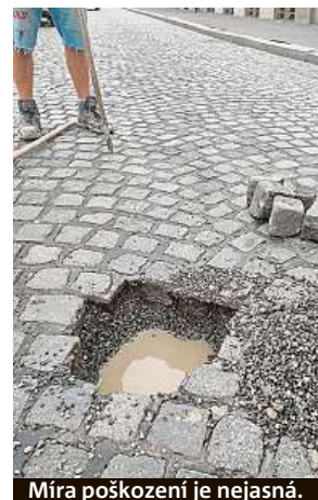
Míra poškození je nejasná.
