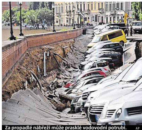
Za propadlé nábřeží může prasklé vodovodní potrubí. AP
