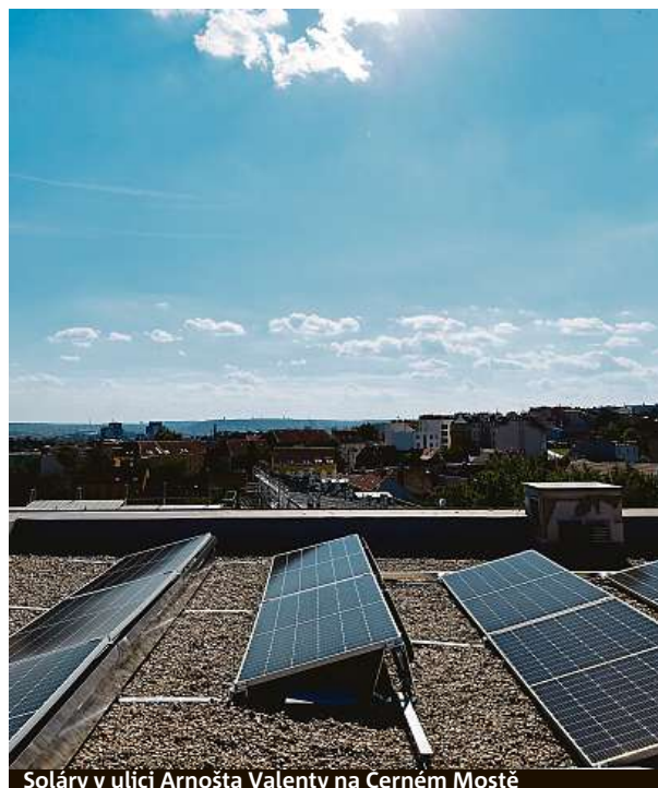
Soláry v ulici Arnošta Valenty na Černém Mostě
