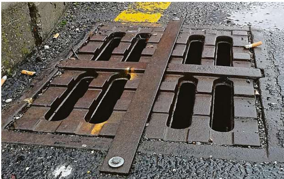
Přišroubované víko kanalizace na jedné z pražských ulic. Na řetěz ale musejí některé věci přivazovat i v soukromých firmách.
