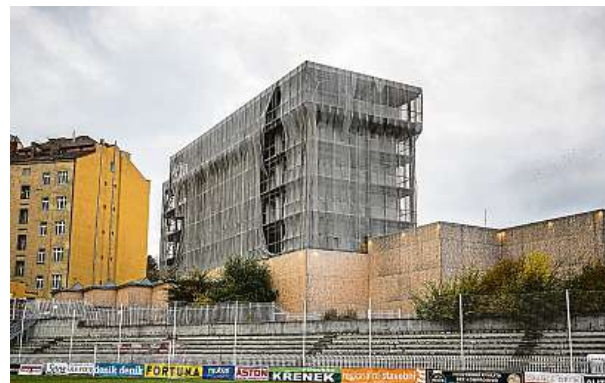
Smutnou kapitolou v historii ÚSTR byla nepovedená rekonstrukce jeho sídla na pražském Žižkově.
