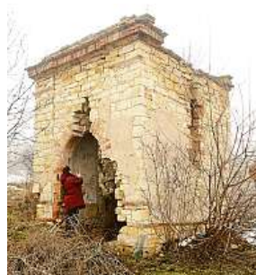
Na fotografii je vidět zřícenina v Evani před zahájením oprav.
