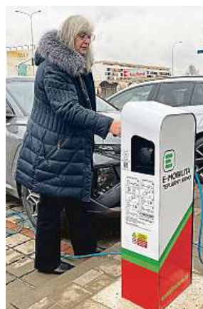
Dobíjecí stanice u lužáneckých bazénů TEPLÁRNY BRNO
