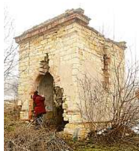
Na fotografii je vidět zřícenina v Evaňi před zahájením oprav.
