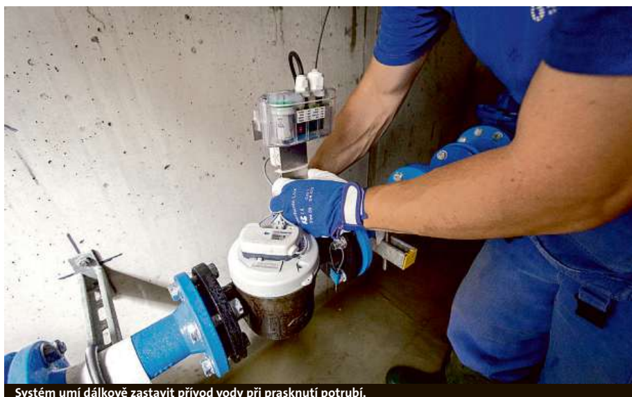
System umí dálkově zastavit přívod vody při prasknutí potrubí.
