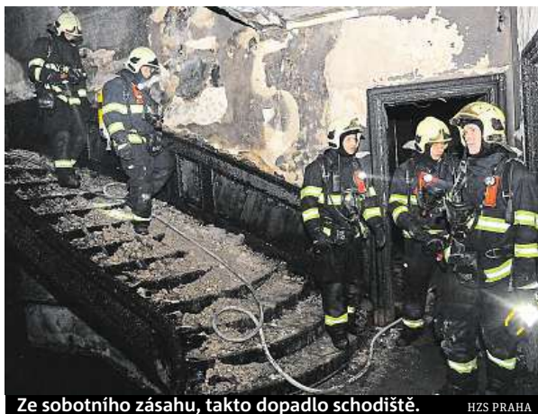
Ze sobotního zásahu, taktó dopadlo schodiště. HZS PRAHA
