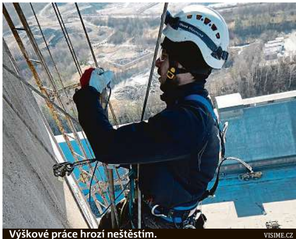
Výškové práce hrozí neštěstím.
