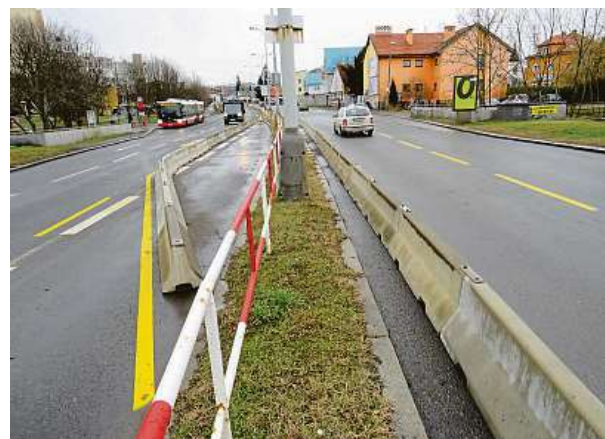
Pod silnicí vede podchod, který je ve špatném stavu.
