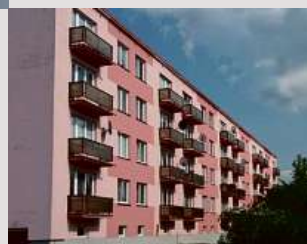
Původní stav bytového domu - havarijní stav balkonů
