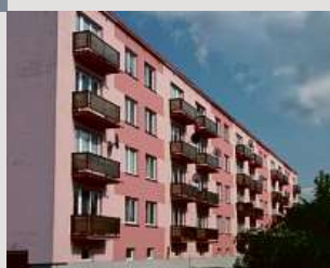
Původní stav bytového domu - havarijní stav balkonů
