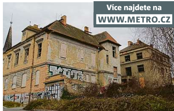
Kočího vila je ve velmi špatném stavu.
