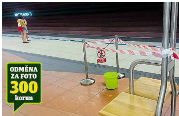
V nové stanici Bořislavka kape voda ze stropu. NIKOLA OROZOVIČ
