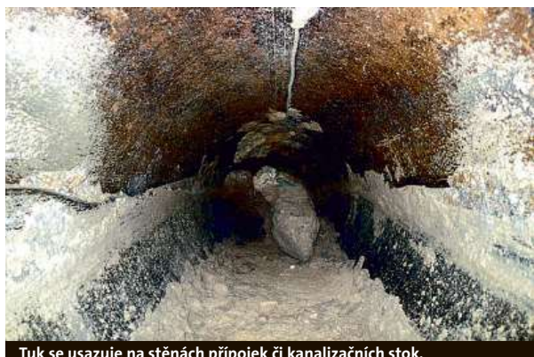
Tuk se usazuje na stěnách přípojek či kanalizačních stok.
