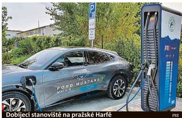
Dobíjecí stanoviště na pražské Harfě
