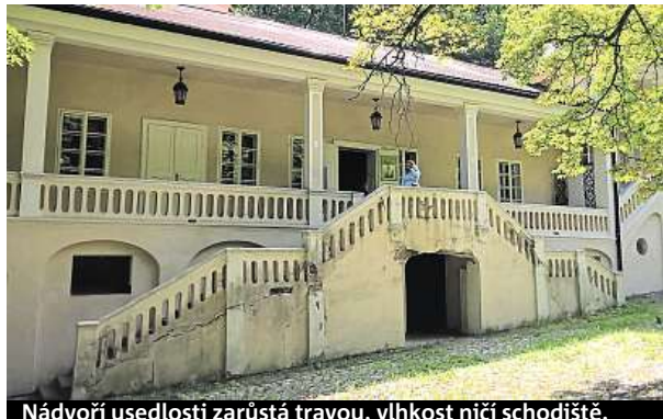
Nádvoří usedlosti zarůstá travou, vlhkost ničí schodiště.
