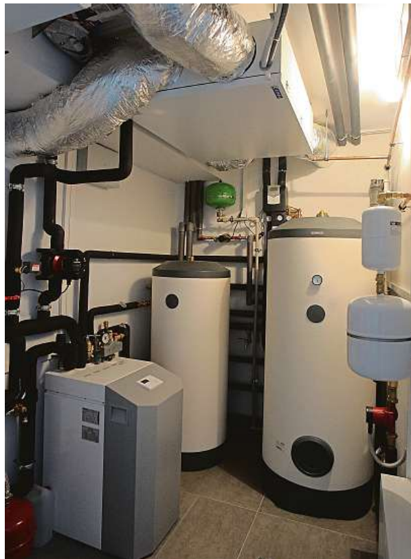
Technické zázemí úsporného rodinného domu s tepelným čerpadlem a rekuperační jednotkou připomíná spíše laboratoř. MAFRA
