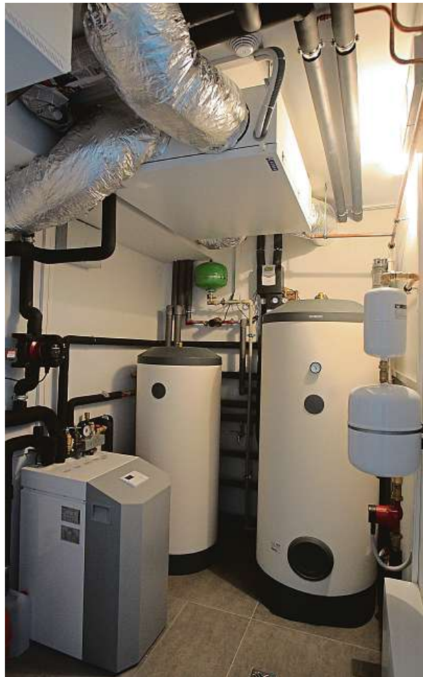
Technické zázemí úsporného rodinného domu s tepelným čerpadlem a rekuperační jednotkou připomíná spíše laboratoř. MAFRA
