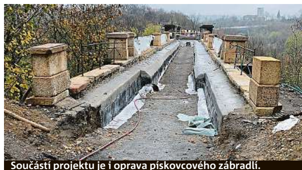
Součástí projektu je i oprava pískovcového zábradlí.
