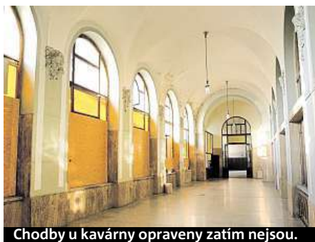
Chodby u kavárny opraveny zatím nejsou.
