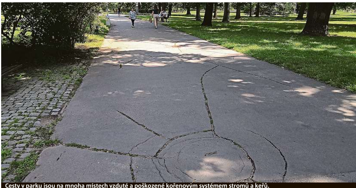
Cesty v parku jsou na mnoha místech vzduté a poškozené kořenovým systémem stromů a keřů.
