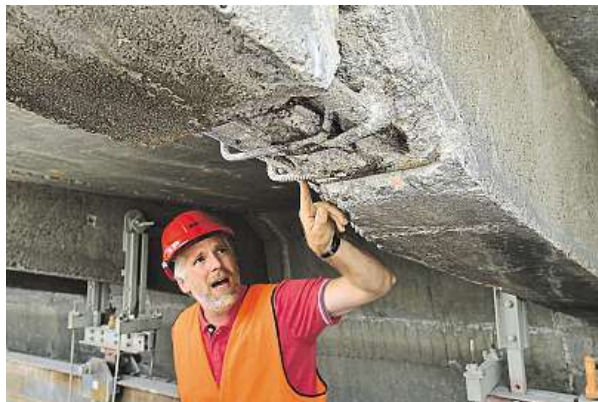
Je třeba opravit rezavějící železné části ukryté v betonu.
