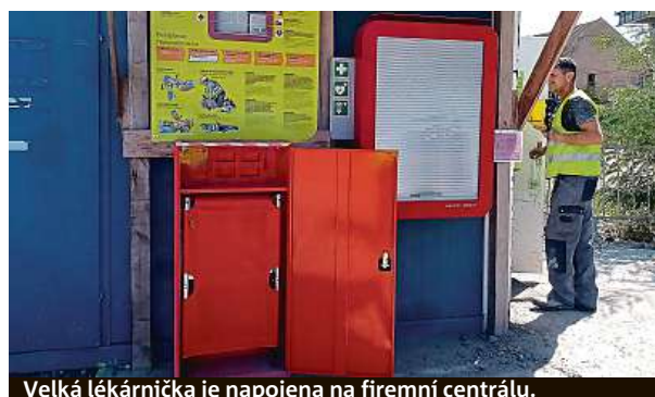
Velká lékárníčka je napojena na firemní centrálu.
