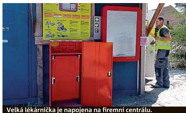
Velká lékárníčka je napojena na firemní centrálu.
