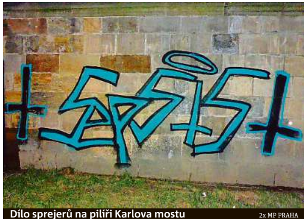
Dílo sprejerů na pilíři Karlova mostu
