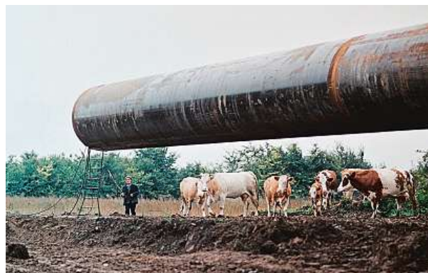
Ropovod vystavěly státy v čele se Sovětským svazem. Hlavním účelem bylo zásobovat státy socialistické soustavy.
