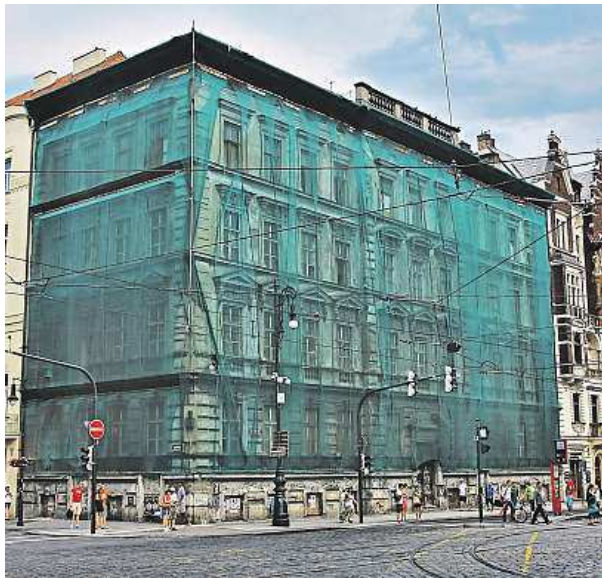
V únoru 2013 se z horního patra ulomil kus římsy a spadl na chodník. Od té doby je dům zakryt ochrannou sítí.
