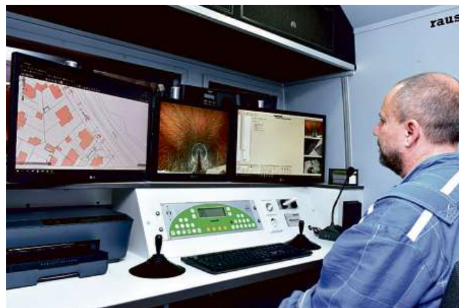
Pracovníci PVK loni zkontrolovali 144 kilometrů kanalizační sítě.
