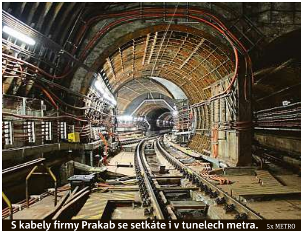
S kabely firmy Prakab se setkáte i v tunelech metra. 5x METRO
