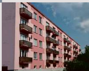
Původní stav bytového domu - havarijní stav balkonů
