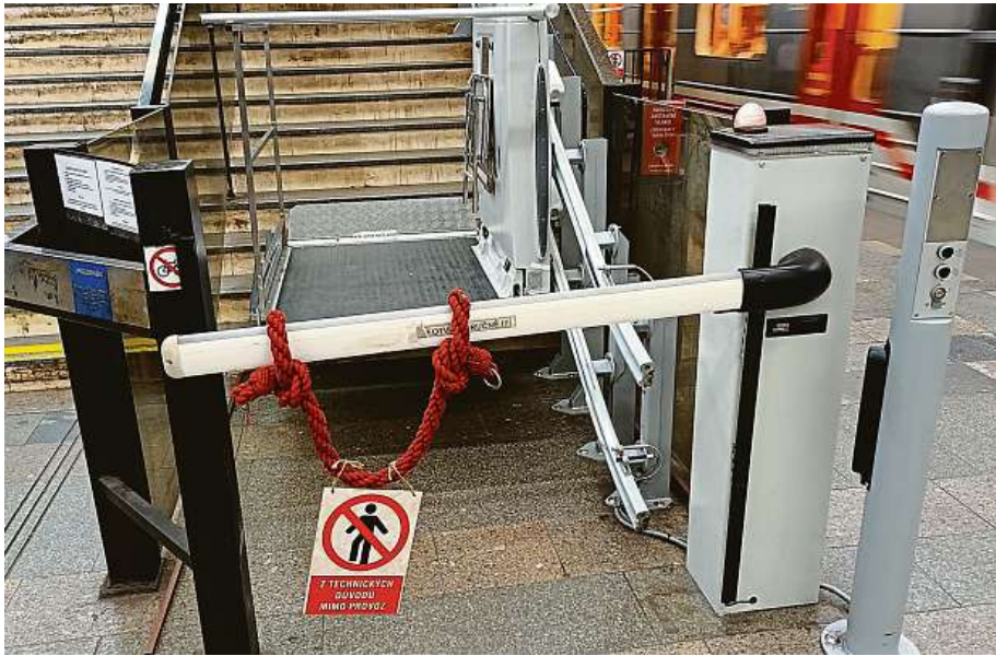
„Nová plošina na Strašnické se opět porouchala,“ hlásil nám začátkem letošního srpna čtenář deníku Metro Martin Stehlík. Svůj postřeh doplnil také několika fotografiemi přímo z místa.
