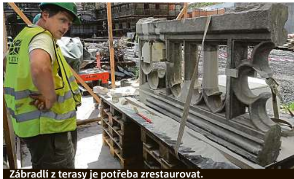
Zábradlí z terasy je potřeba zrestaurovat.
