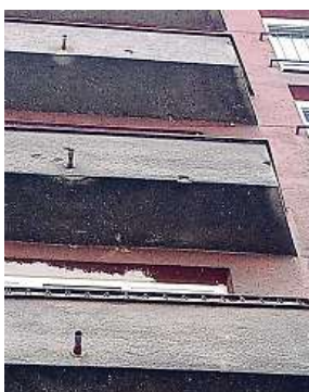
Pozůstatky po střelbě na fasádě domu na Vinohradské třídě
