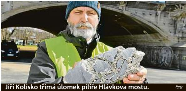
Jiří Kolisko třímá úlomek pilíře Hlávkova mostu. ČTK
