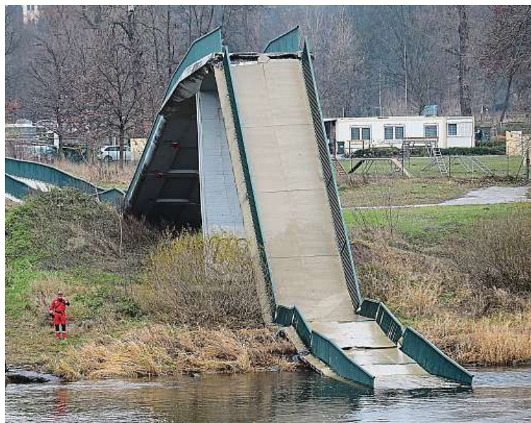
Trojská lávka se nezřítla, protože po ní pochodovala vojenská jednotka. Do mostní konstrukce dlouhodobě zatékalo.
