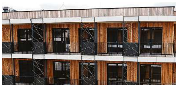
Dřevěný plášť na střeše zesvětľal, je vystavený povětrnostním vlivům víc než obložení v lodžích bytů. Jejich odstín by se měnit neměl.
