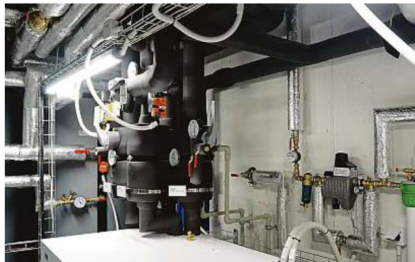
Technologickým mozkiem je otopný systém využívající pro každý dům několik geotermálních vrtů k tepelným čerpadlům.
