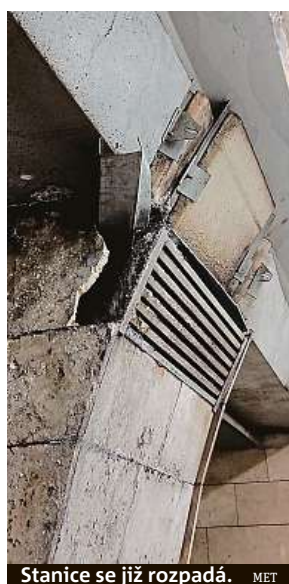
Stanice se již rozpadá. MET
