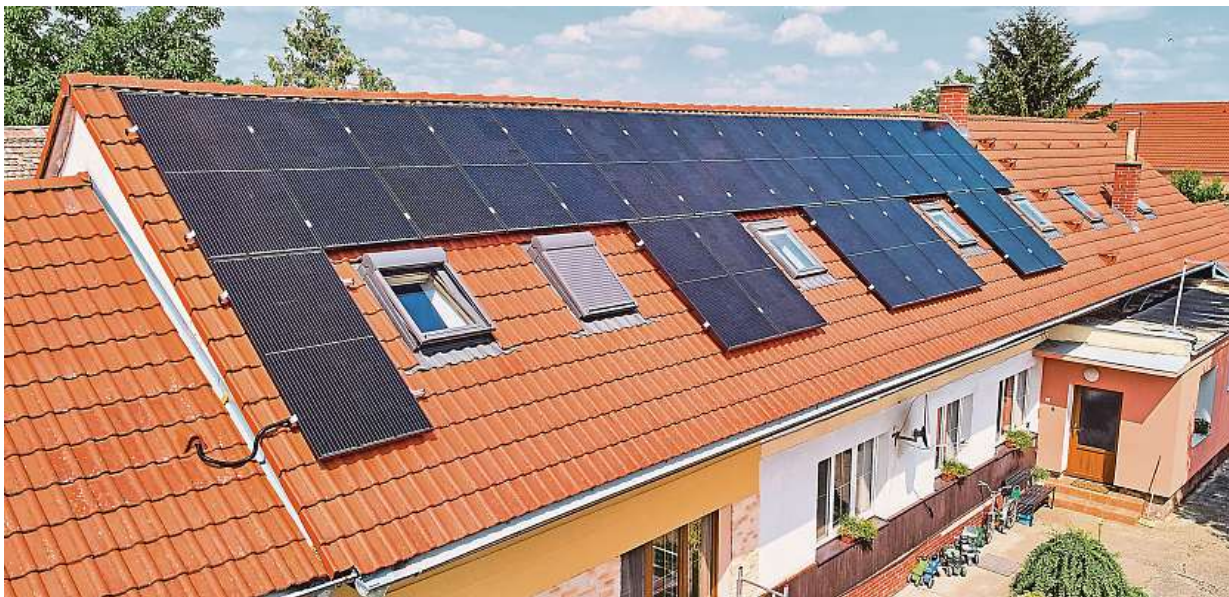
Popularita fotovoltaických elektráren neustále stoupá a řada majitelů domů se zajímá o možnost instalace na starší nemovitosti. FVE lze instalovat i na starší budovy, je však třeba věnovat zvýšenou pozornost stavu střechy a původní elektroinstalaci.
