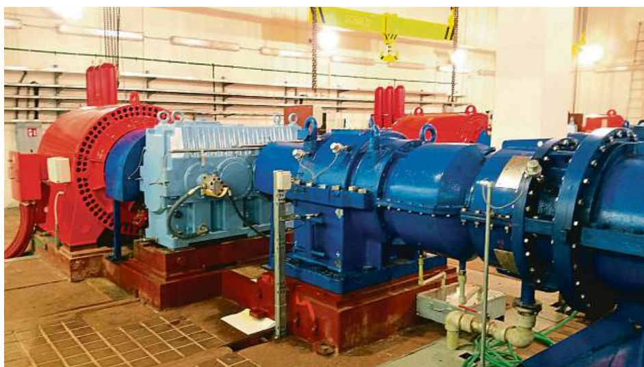
Turbosoustrojí vodní elektrárny na Vltavě v Praze Lahovicích
