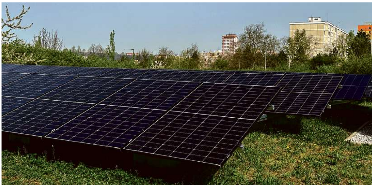
Vodohospodáři letos instalují 4 000 panelů o výkonu 2 200 kWp, které ročně vyrobí 1 920 MWh elektrické energie.
